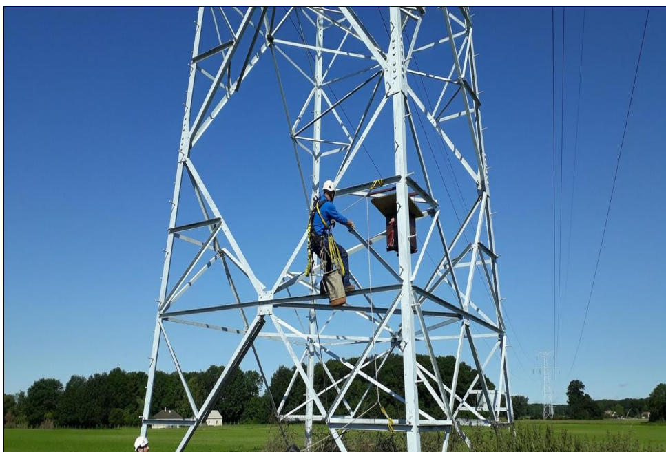
Le nichoir est installé sur un pylône.
